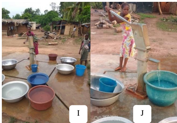
Planche n°4 : Pompe à hydraulique villageoise au quartier Baoulé Prise de vue : Aké-Awomon, 2021
