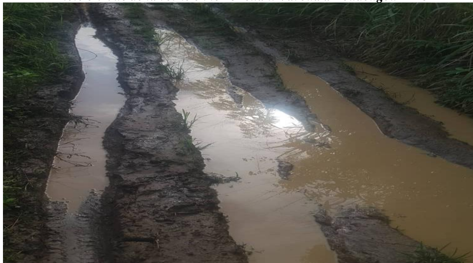
Photo 5 : Vue de la voirie en terre reliant Vavoua à Koudougou PK 8
